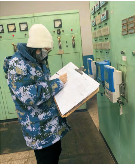
下陆加压站值班人员正在记录生产数据
